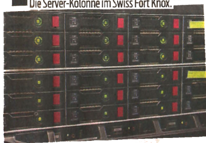
20 Meter lang, wenig spektakulär, dafür sehr sicher: Die Server-Kolonne im Swiss Fort Knox.
